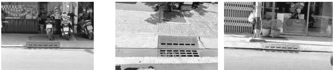
Hình 6. Các cửa thu nước kiểu thu kết hợp đang được sử dụng trên các tuyến đường phường 1, thành phố Vĩnh Long
